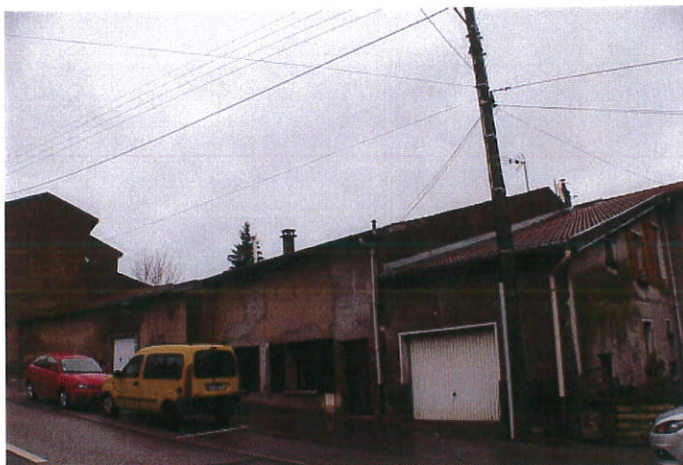
Figure 4.7.5 : Maisons anciennes dégradées
